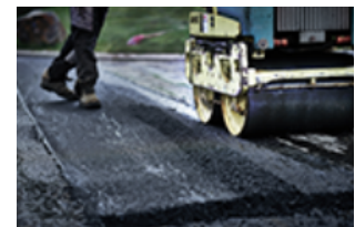
A1508_Verdichtung.jpg Das professionelle Verdichten besorgt ebenfalls eine Ammann-Maschine, hier eine handgeführte Walze.
